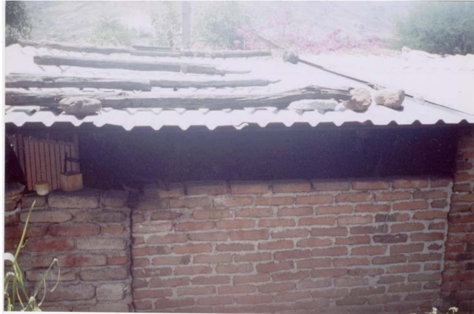
Fig. 11. Vivienda con muros sin aplanado y techo no de cemento
