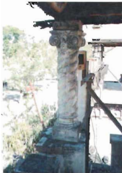
06 Vista de mirador poniente; se observa la pérdida de canalón, estallamiento de columna y presencia de letrero metálico.
