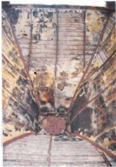
04 Vista de bóveda de mirador, se aprecia la pérdida de recubrimiento en la capa de compresión.
