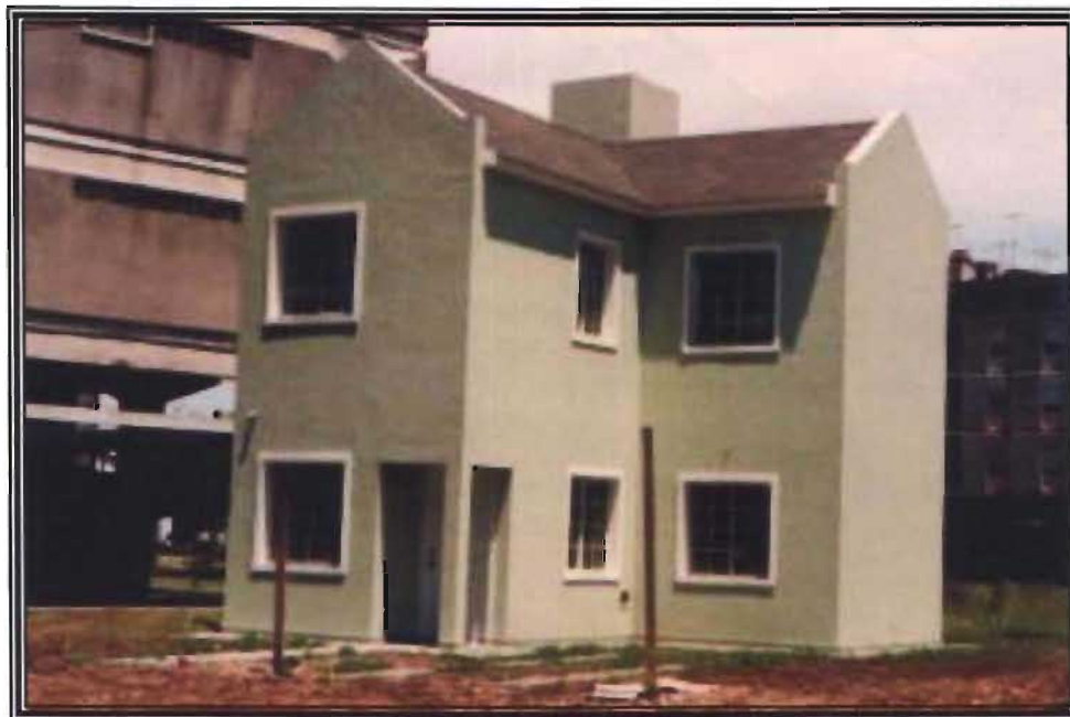
Ejemplo de Fabricación de Estructura de Acero para vivienda (Casa Tolosa). Fuente 79
