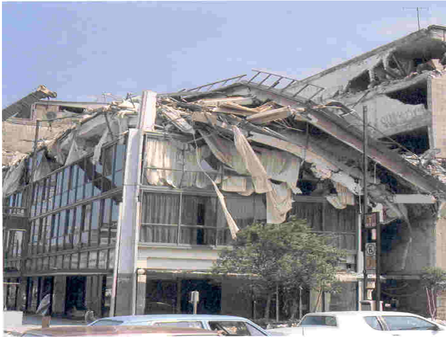
Figura 25. Efecto del sismo de 1985.
