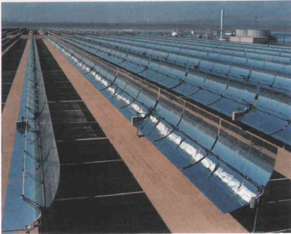
Figura 4.17. Esta es 1 de 9 plantas generadoras de energía eléctrica a base de concentradores solares de canal parabólico, que están ubicadas en el desierto de Mojave, California, y tienen la mayor capacidad de generación de electricidad a partir de la energía del Sol a nivel mundial, alcanzando una potencia de 354 megawatts que satisface las necesidades de 500,000 personas. El aceite que circula por los tubos receptores recoge la energía solar captada en forma de calor y la transporta a una planta eléctrica para generar electricidad.
