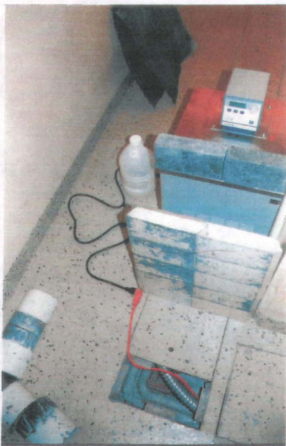
Foto No.5. Equipo de recirculación de líquido refrigerante. Se observan las hojas y bloques de plomo para su protección de la radiación.
