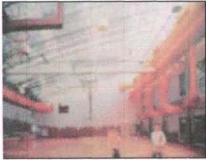
Foto 38 Ocultación de tuberías.
