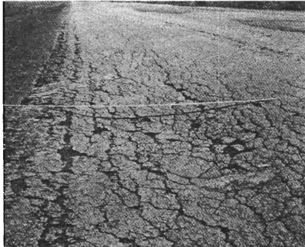
Figura 3.3 Falla estructural generalizada. (ref. 4)
