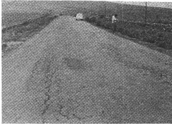
Figura 3.1 Grietas longitudinales y distorsiones generales. (ref. 4)
