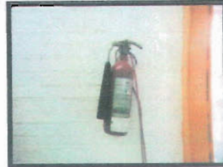
Imagen 8 extintor no señalizado
