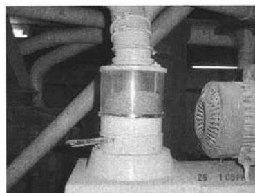
Entrada a la descascarilladora de arroz
