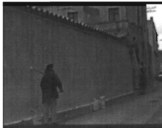
Foto 34 Preparación del muro en Ussana; se aplicó sellador contra álcali, sellador vinílico y blanco como fondo.
