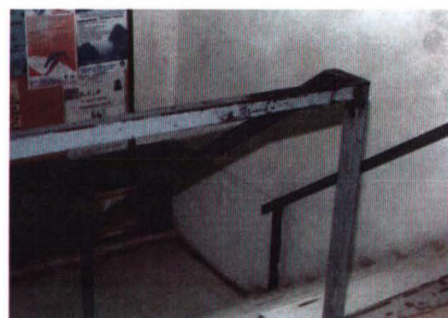
Deterioro de instalaciones
