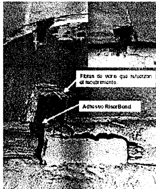
Fig. 10 Acabamiento de las muestras tomadas a martillo y cizalla en el recubrimiento. Nótese el excelente estado de la superficie bajo el recubrimiento a dos años de instalado el producto. Este aspecto se presentó en todas las muestras tomadas a ambos ductos. En la figura se aprecia también la composición a base de fibras del recubrimiento.
