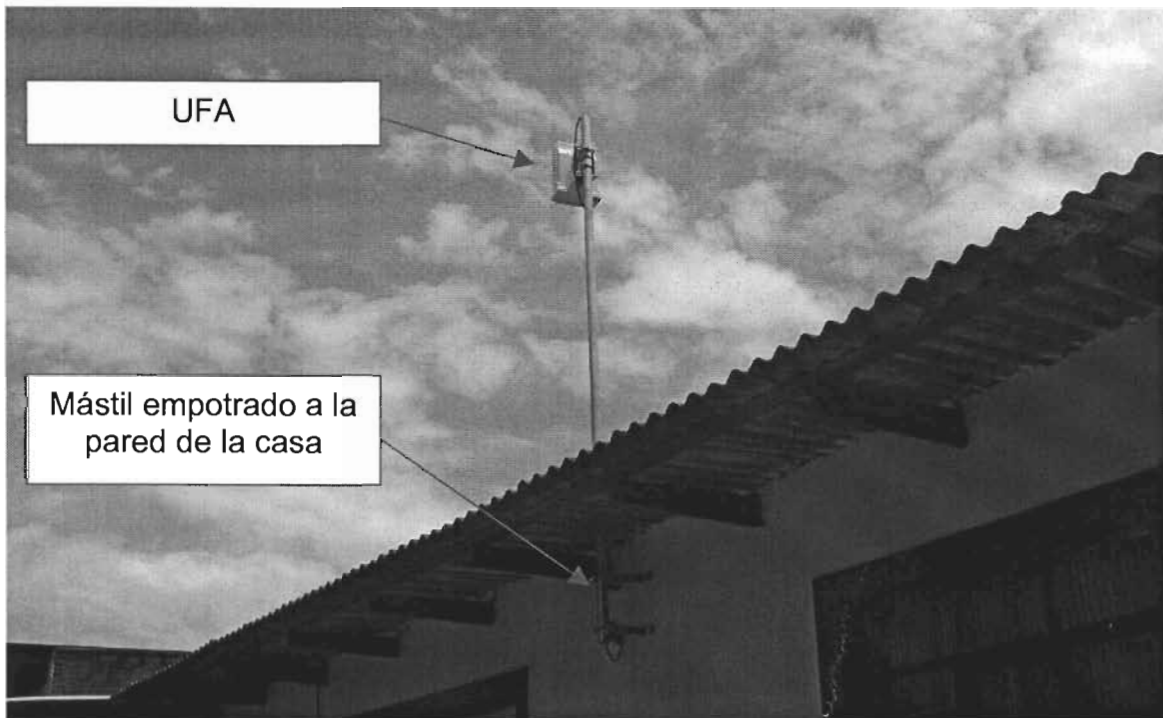
Figura 4.35. Instalación de la UFA.
