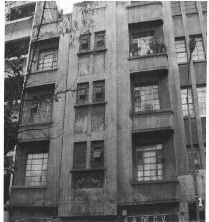
EDIFICIO DETERIORADO EN CALLE LÓPEZ.
