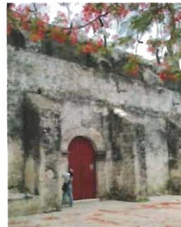
Contrafuertes exteriores desalineados de los interiores en la capilla de San Lorenzo, Tahmek, Yucatán Foto: A. Román
