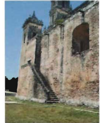
Escalera de rampa sencilla en la parroquia de San Pedro, Yaxcabá, Yucatán Foto: A. Román
