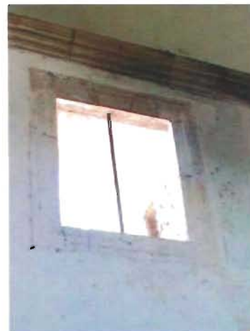
Platabanda en la ventana alta de la nave de la parroquia de San Pedro Yaxcabá, Yucatán Foto: A. Román
