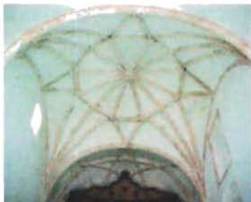
Bóveda baida con nervaduras de cantería en la nave conventual de San Bernardino de Sena, Sisal, Yucatan Foto: A. Román
