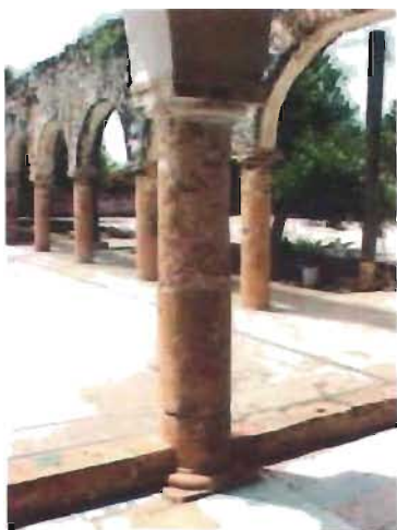
Columnata del claustro del convento de San Juan Bautista, Tekax, Yucatán Foto: A. Román
