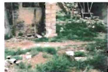
Zapata de mampostería ubicada en la crujía norte del convento de San Francisco, Conkal, Yucatán Foto: A. Román
