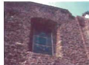
Capialzado de piedra laja de tezontle en la iglesia de San Hipólito, México, D.F. Foto: A. Román
