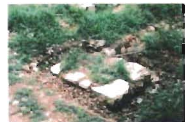
Detalle de zapata de mampostería en la crujía norte del mismo convento Foto: A. Román
