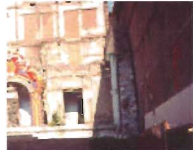
Muro de mampostería nucleada en el costado poniente del ex convento de San Francisco, México, D.F.
