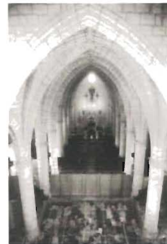
Vista de la catedral de Santo Domingo, República Dominicana donde se observa las zapatas de las columnas de sillares.
