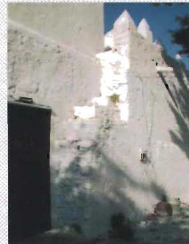
Costado sur del presbiterio. Diferencias de anchos en los muros de mampostería de este con los de la nave
