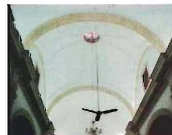
Bóveda baída lisa en la nave de la capilla de Santa Ana, Mérida, Yucatán Foto: A. Román
