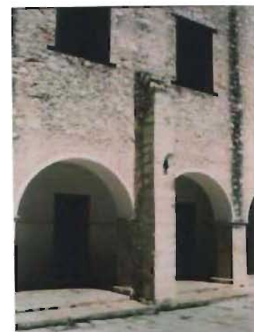
Contrafuertes del claustro bajo del convento de la Mejorada, Mérida, Yucatán. Foto: A. Román
