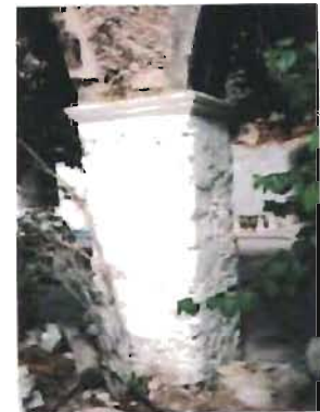
Detalle de pilar en el claustro oriente del convento de San Francisco, Conkal, Yucatán. Foto: A. Román
