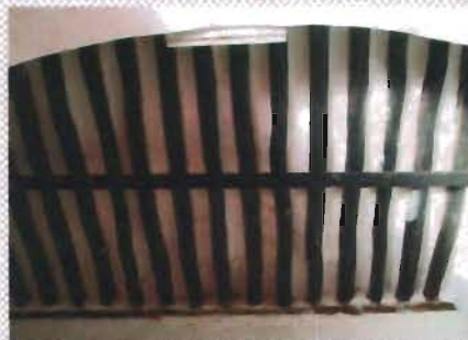
Techumbre de rollizos reforzada con una viga metálica en el anexo de la capilla de San Juan Bautista, Abalá, Yucatán
