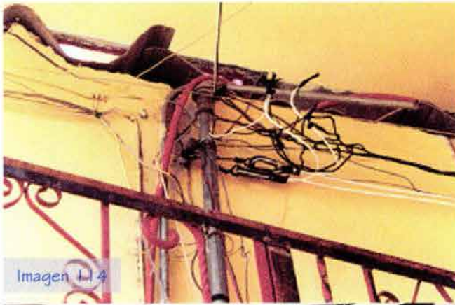
Detalle de instalaciones eléctricas deficientes
