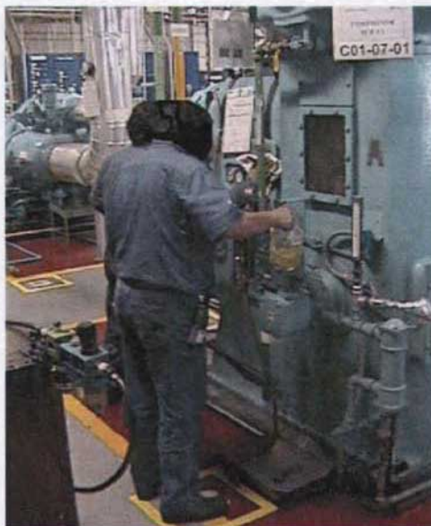
Figura 5.3.4.- Operadores ejecutando un listado de verificación. (Fuente: Industria Automotriz)
