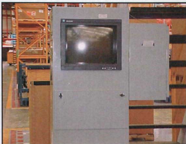
Figura 6.5.3.- Monitor de llamado (Fuente: Industria Automotriz).
