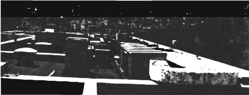
Figura No. 5.91. Equipos tipo divididos en edificio de diseño y comunicación
