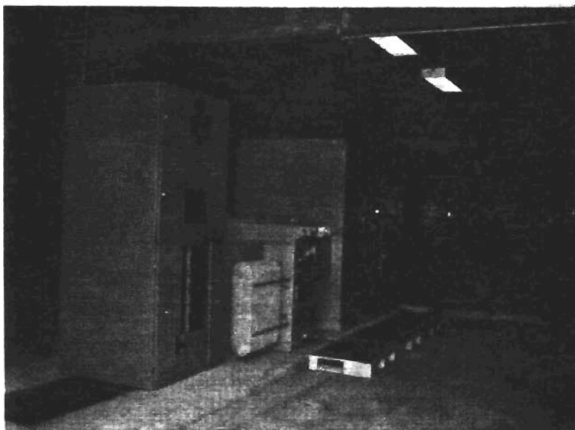
Figura No. 5.14. Vista del interior de la subestación No. 6, de izquierda a derecha se muestra el gabinete autoportado de distribución de B. T. a 220V, transformador reductor tipo pedestal enfriado en aceite de capacidad de 500 KVA y gabinete seccionador de A. T. con capacidad nominal de 23 kv.
