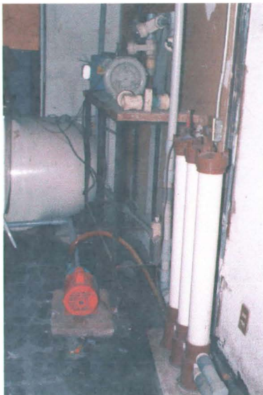
Sistema de filtros y bombeo del agua
