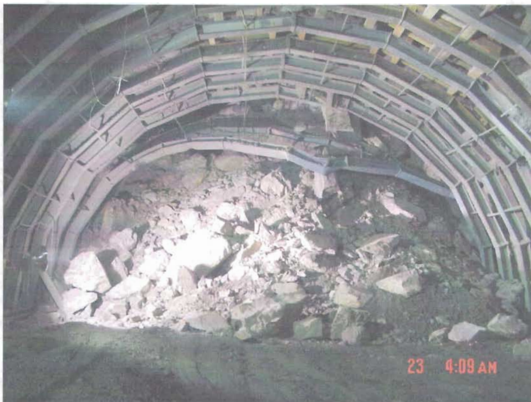
Fotografía 7.1.- Tomada por el lado de aguas abajo de la falla, cadenamiento 0+168 a 0+195.5; nótese la fragmentación de la roca que nos da idea de la intensa alteración y fracturamiento del macizo rocoso.
