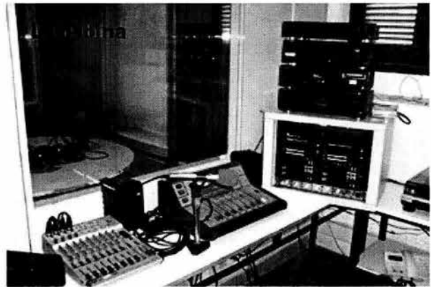
Cabina de radio
