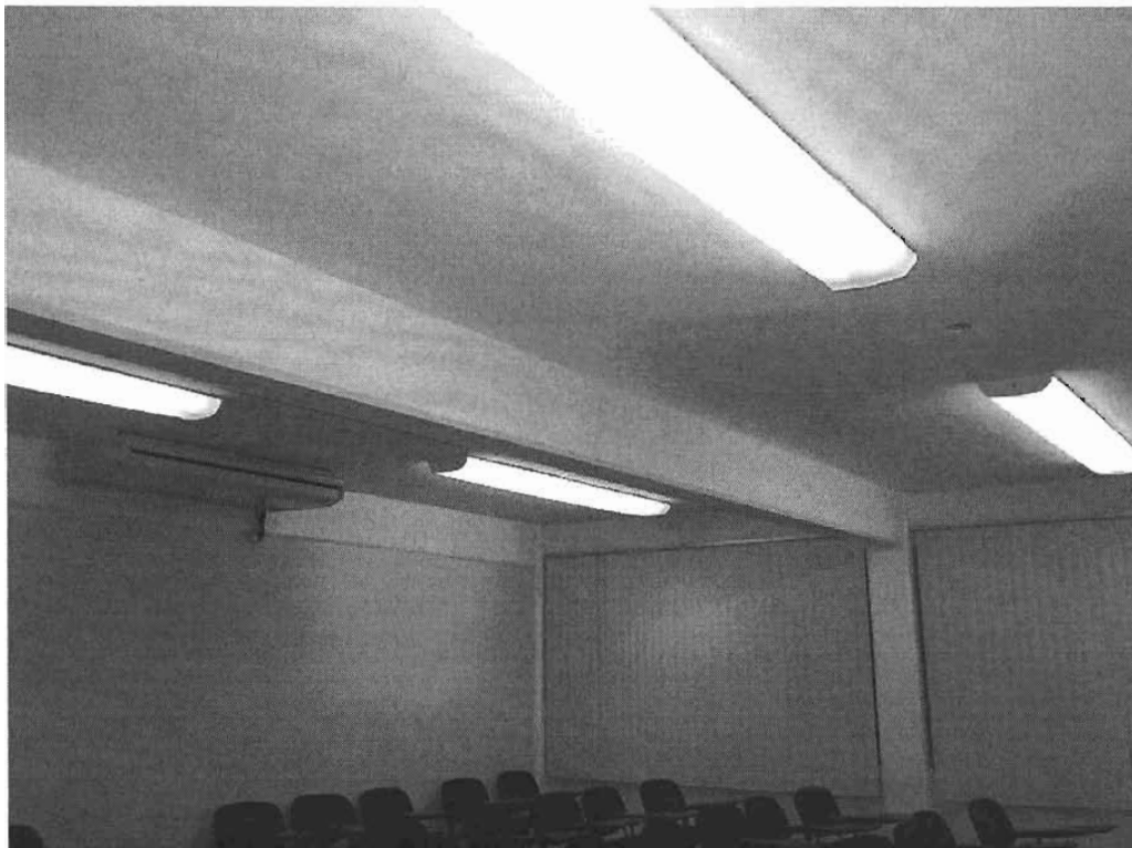
Figura 5.1.8 Salón con gabinetes de lámparas fluorescentes de 2 x 75W
