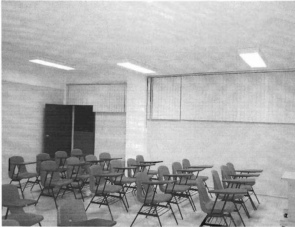
Figura 5.1.7 Salón con gabinetes de lámparas fluorescentes de 2 x 39 W
