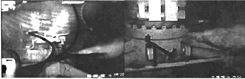
^Figura 3.15 Muestra el efecto de un brote de gas en el conector de la cabeza, teniendo como efecto el rompimiento de los sellos de la brida del preventor.
