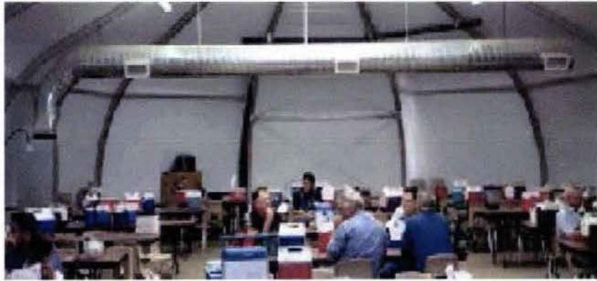
Figura 81. Ejemplo del sistema de aire acondicionado.
