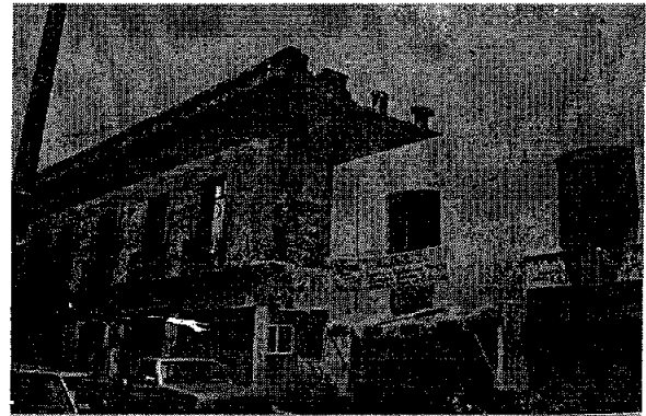
En la calle Ernesto Pugibet el deterioro también es evidente
