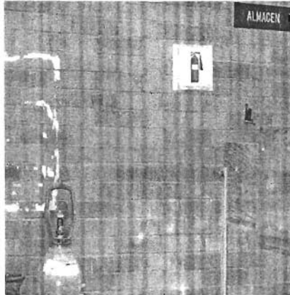
Figura 4.5.- Falta de equipo contra incendio en el laboratorio de procesos de manufactura.
