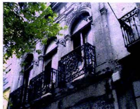
Edificio dañado y deteriorado. Av. Juárez (entre Luis Moya y José Ma. Marroquí)
