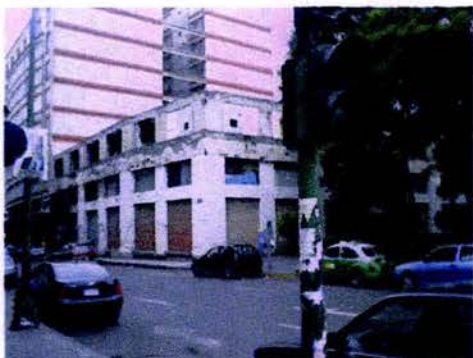
Edificio dañado y deteriorado. Av. Independencia y José Ma. Marroquí
