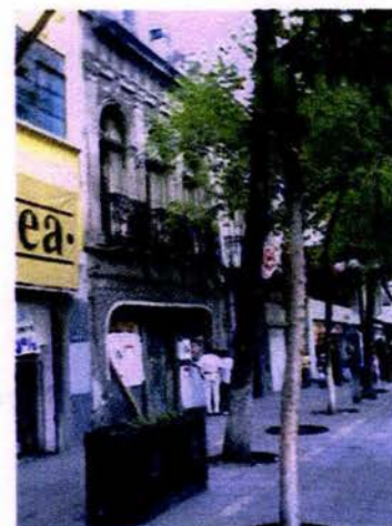
Edificio dañado y deteriorado. Av. Juárez (entre Luis Moya y José Ma. Marroquí
