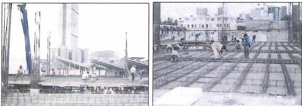
Figura 6.21. Instalación de los torones de preesfuerzo en las nervaduras de las siguientes etapas de la losa y en las traves de la estructura.
