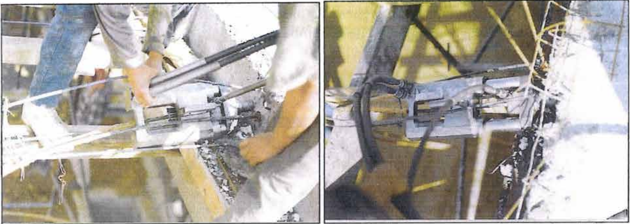
Figura 6.16. Instalación del gato de preesfuerzo en un torón de losa y proceso de la carrera de los pistones internos hasta lograr la presión y fuerza de tensión de diseño.
