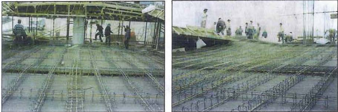
Figura 6.20. Losa para las rampas de entrepisos, inicio en piso inferior y llegada en el piso superior.
