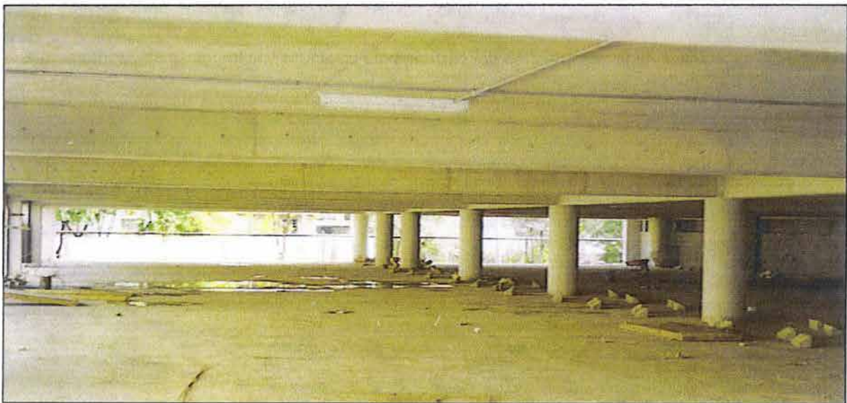
Figura 6.25. Aspecto de la estructura en los espacios interiores, con el objetivo de amplitud logrado, se aprecian los peraltes reducidos de las trabes en comparación con la longitud de los claros.
