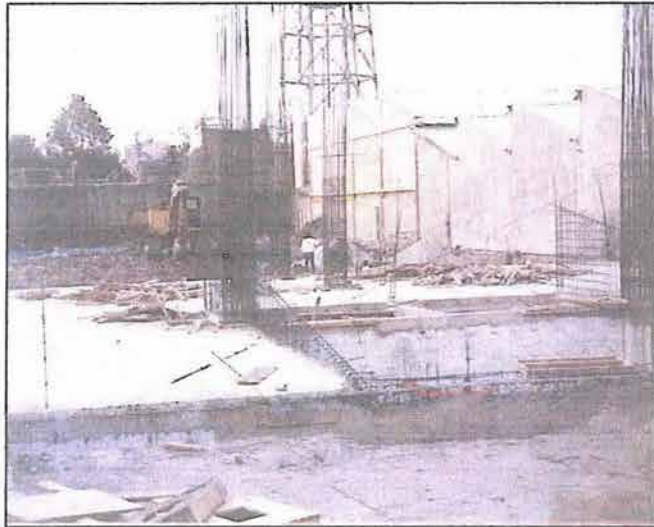
Figura 6.1. Inicio de excavaciones en el lado norte del predio para el edificio.
