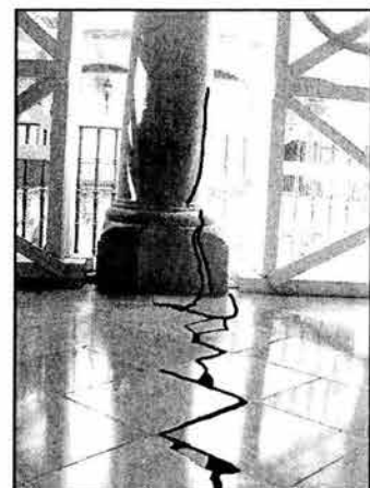
Fig IV.6 Columna y losa afectadas en planta alta
