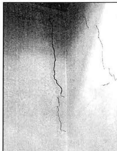
Fig. IV.29 Separación de muros en la crujía sur
