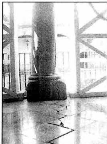
Fig V.13 Daños de la losa en la zona afectada
