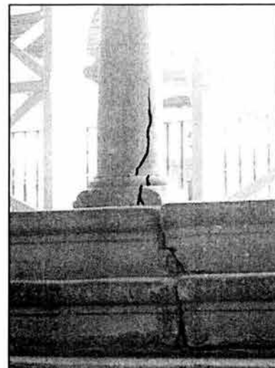
Fig V.8 Columna 15, primer nivel
