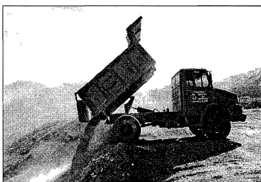
Fig. VIII.4 Creación de tiraderos de escombros cerca del Panteón Jardines del Recuerdo, que pueden incorporarse en un flujo de detritos en caso de precipitación abundante.
