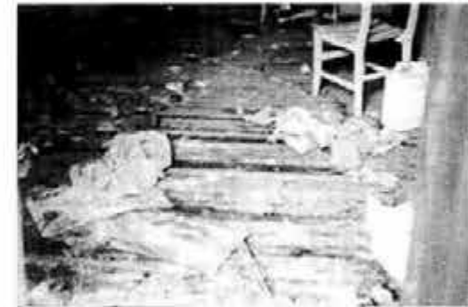
Fragonard No. 43. Humedades. Putrefacción de la madera.
