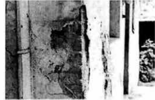
Fragonard No. 43. Desprendimientos de aplanados en los muros de la fachada interior.
