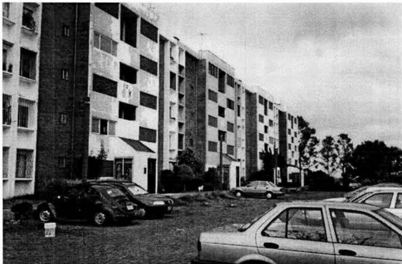
Este conjunto luce en mejor estado, son pocos los elementos que lucen deteriorados.
