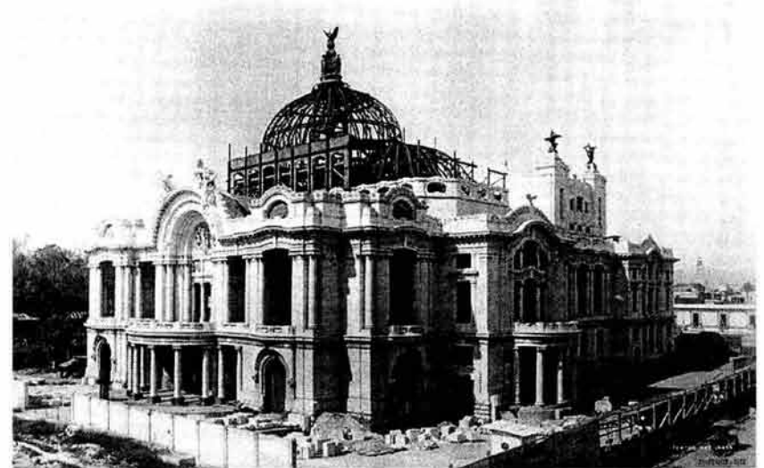
Construcción del Palacio de Bellas Artes, Arq. Adamo Boari, 1896. AGN, Colección Fotográfica de Propiedad Artística y Literaria, Compañía Industrial Fotográfica, Ciudad de México, foto 126.
