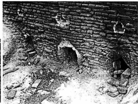
Figura 2.14 Bóveda de alimentación de combustible
