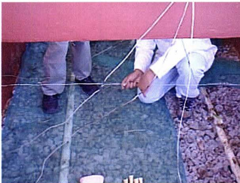
Fotografía 15. Instalación de los termopares antes del llenado de la pila, para monitorear la temperatura.
