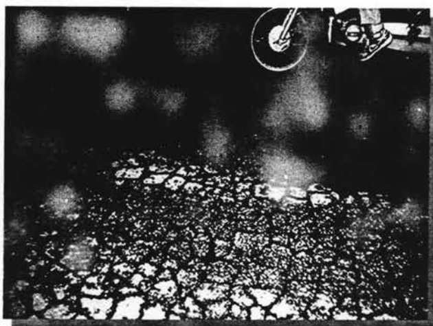
Foto II. 4 Daño superficial severo (piel de cocodrilo)
