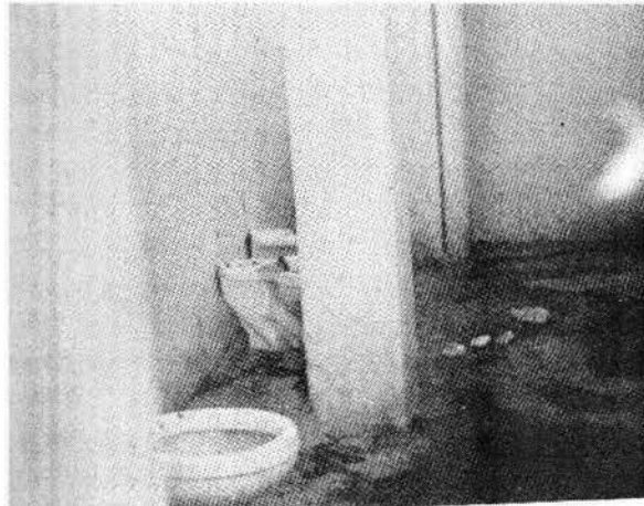
Instalaciones sanitarias inadecuadas.
