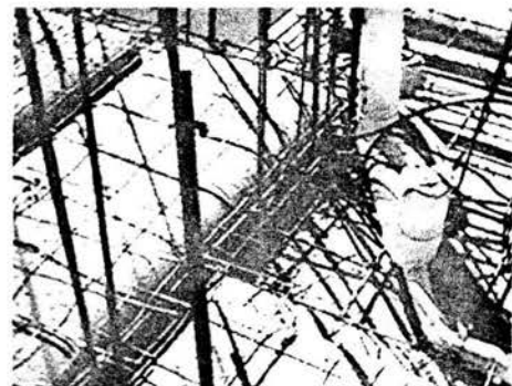
b) Anclajes de entrepiso
