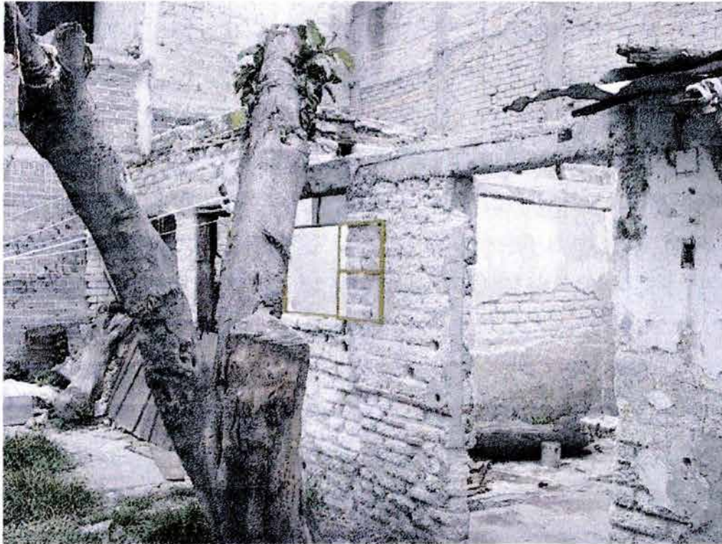
Algunas de las viviendas dentro del predio se han derrumbado.
