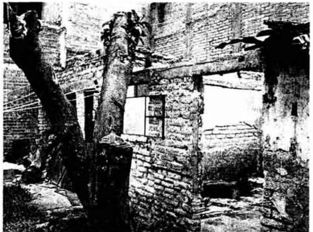
Vivienda deshabitada por derrumbe
