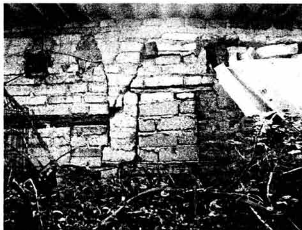
Vivienda en deterioro, representa un riesgo para sus habitantes
