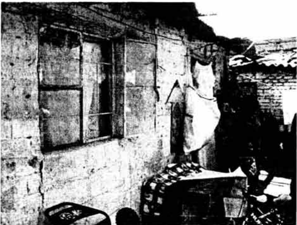
Vivienda en alto grado de deterioro
