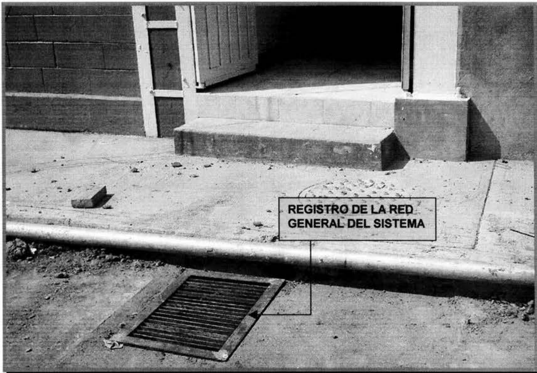
SE OBSERVA REGISTRO DE LA RED GENERAL SISTEMA.
