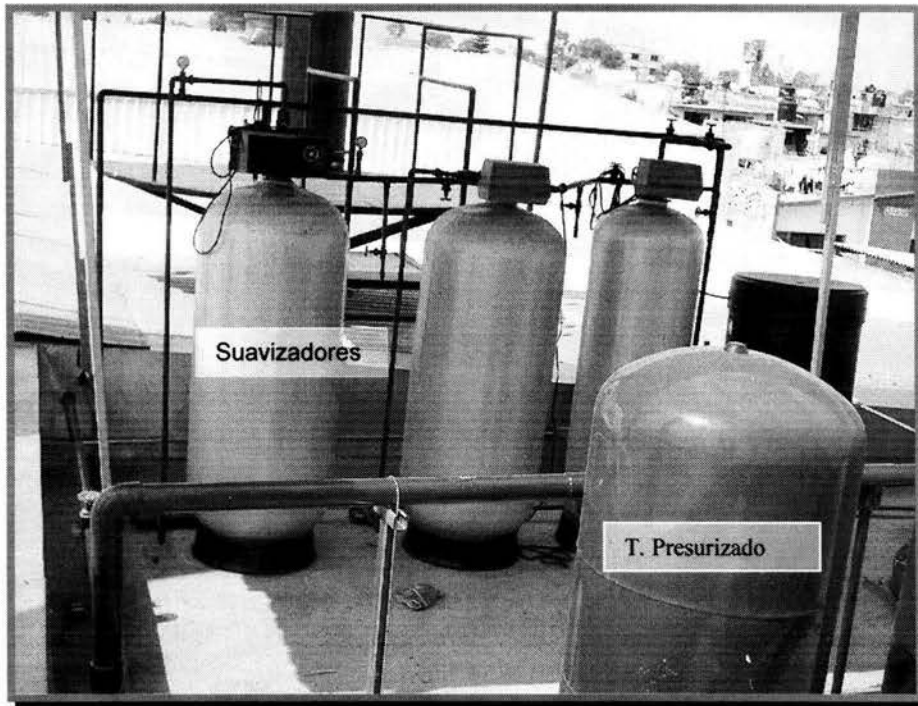
TANQUES SUAVIZADORES Y TANQUE PRESURIZADO.
