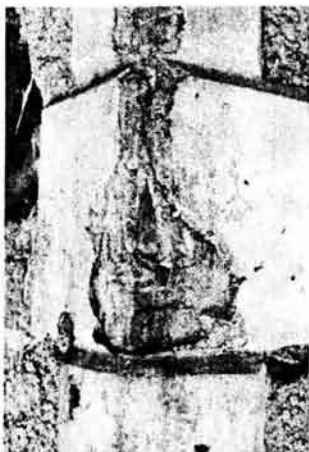
FIG. 34. El estuco se ha desprendido en varios puntos de la decoración de los muros dejando a vista la piedra brasa de su construcción.
