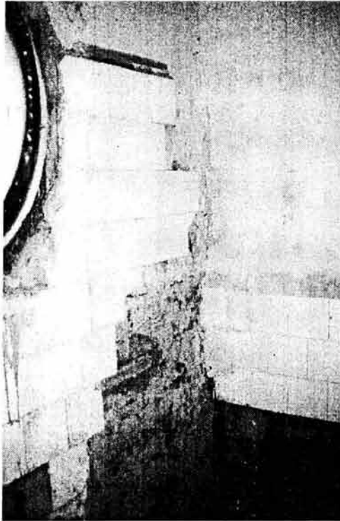
FIG. 43 Vista del recubrimiento del baño en planta alta, donde se evidencia el deterioro: los azulejos originales fueron mutilados, los añadidos destruidos y las piezas sanitarias sustraídas. Foto: JPazGF, 1997.
