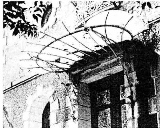
FIG. 58. Esta foto muestra la marquesina del acceso principal lastimosamente dañada, no obstante acusa su morfología original, la cual tiene forma de abanico curvo y ménsulas de herrería decorada en el mismo estilo del resto de la casa. Foto: JPazGF. 1997.
