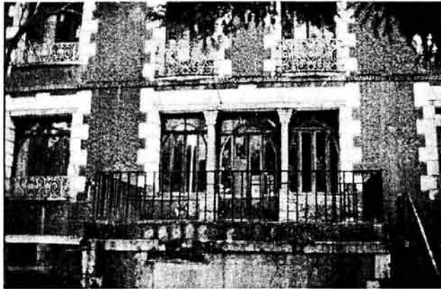
FIG. 39. La terraza se encuentra altamente alterada y deteriorada: daño en elementos estructurales, baranda añadida, aplanados y almohadillados desprendidos, elementos de cantera erosionados, etc.
