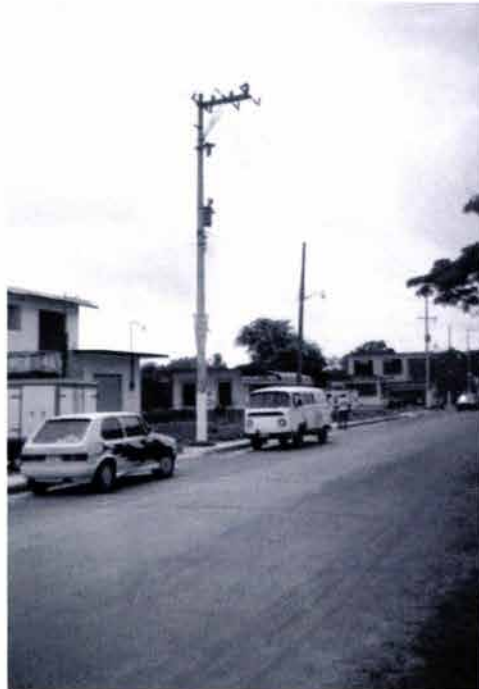
Alumbrado y red vial del acceso al poblado de Playa de Vacas en el Municipio de Medellín, Veracruz.
