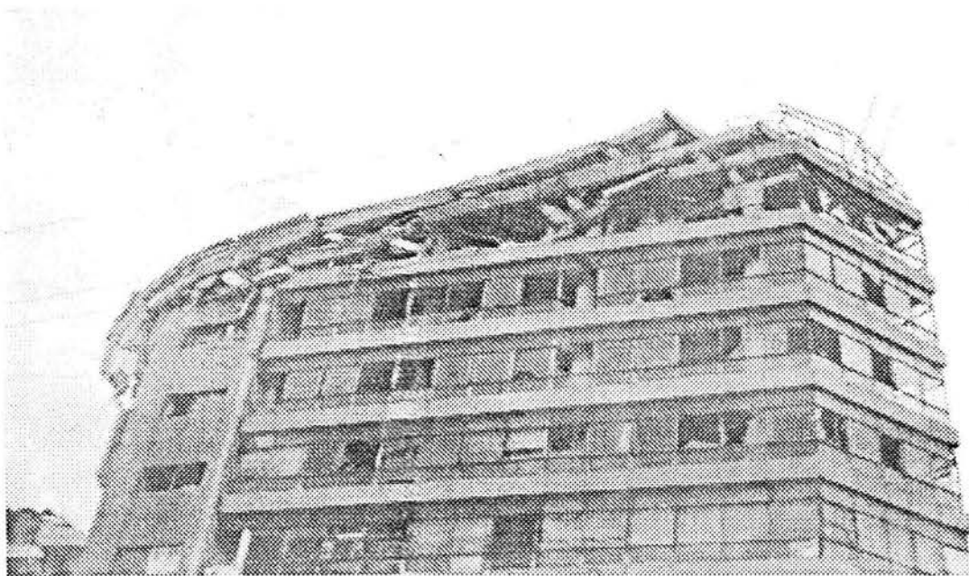
Figura 2.1.1.1. Falla debida a torsión en los últimos pisos de un edificio de esquina.
