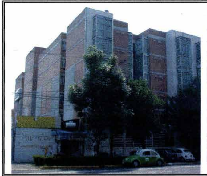
Muros de Concreto Reforzado desplantados desde la cimentación abarcando cuatro niveles Eje Central Lázaro Cárdenas - Eje 4 Sur Xola
