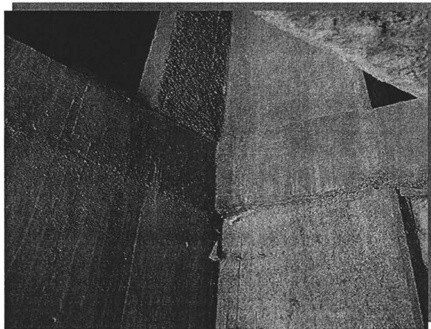
figura 4.10 Junta inexistente entre ala y cuerpo principal
