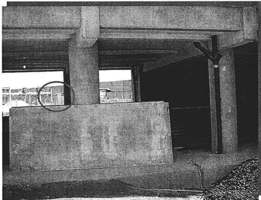
figura 4.12 Columna dañada (marcada en círculo)
