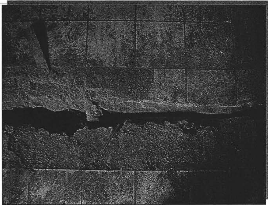
figura 4.11 Junta mínima entre ala y cuerpo principal (fotografía entre losas de ambos edificios)
