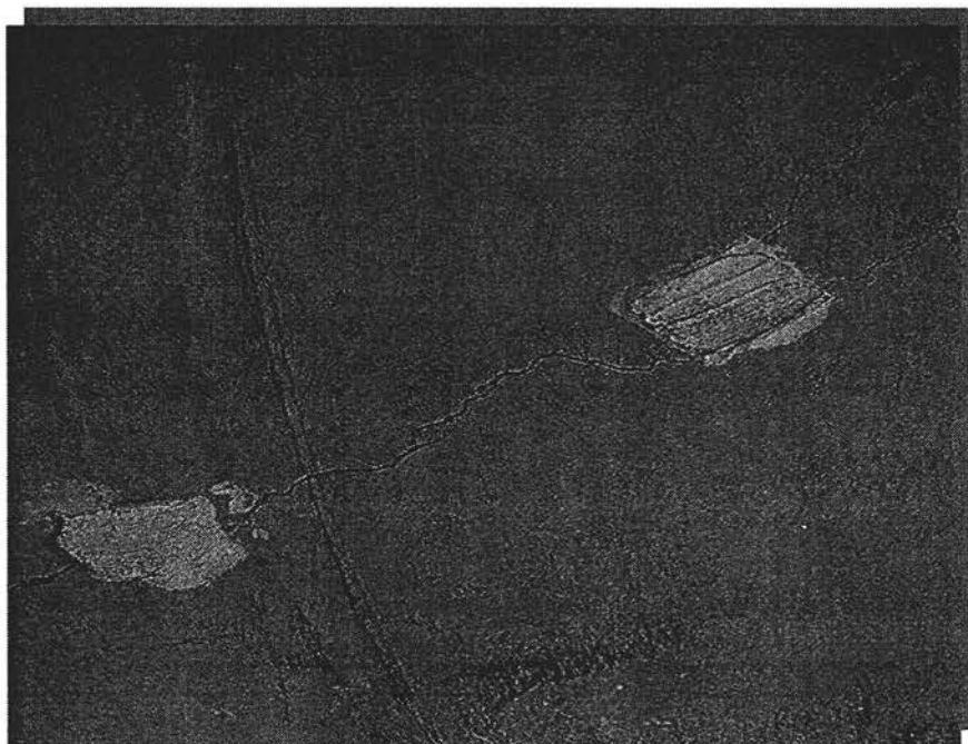
figura 4.13 Columnas dañadas (acercamiento)
