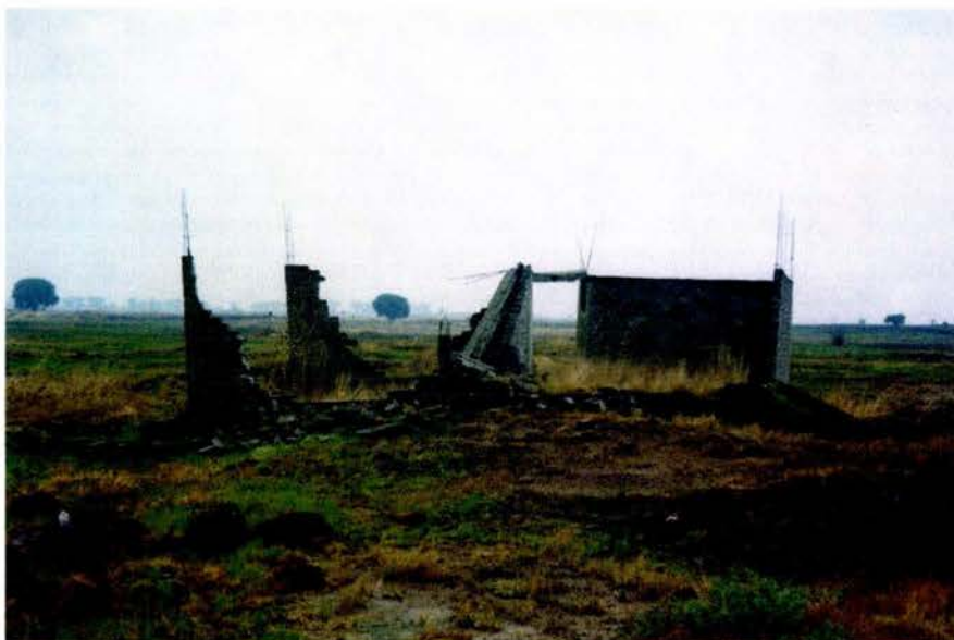
Fig. 5.10 Daños sufridos por cimentaciones superficiales en zona de transición abrupta del lago de Texcoco (Auvinet, 2004)
