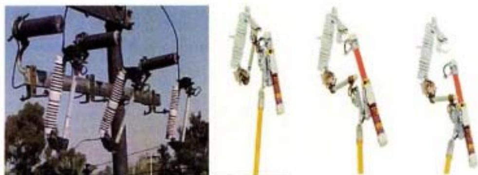
Fig. 2 l) Cortacircuitos y Loadbuster
