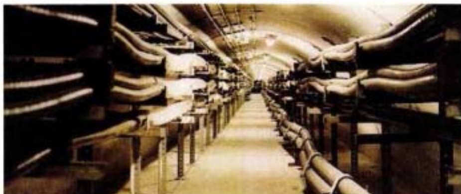
Fig. 2 g) Alimentadores Subterráneos
