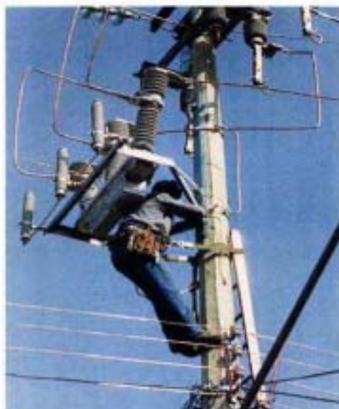
11).-Instalación de medios de seccionamiento para reducción del TIU
