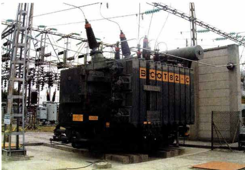
Fig. 2 d) Subestación de potencia reductora 85 kV/23 kV.
