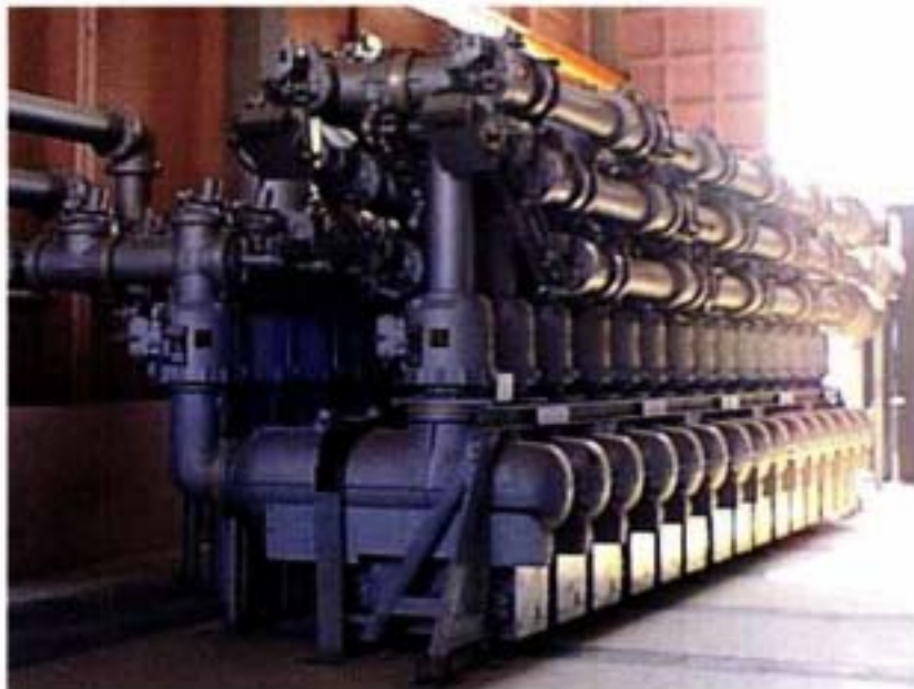
1 j).- Primera Subestación en SF6 ( San Ángel, 1977 )
