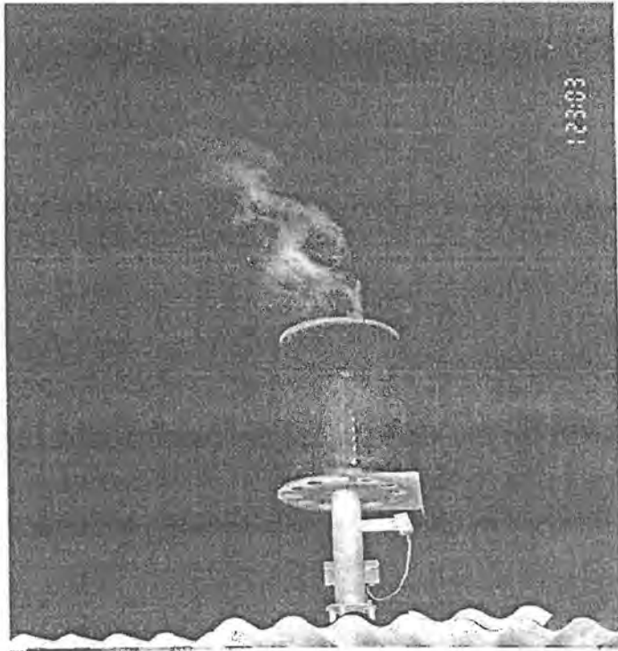
Uso de quemador tipo "Wipping", durante la extracción forzada en el relleno sanitario Prados de la Montaña
