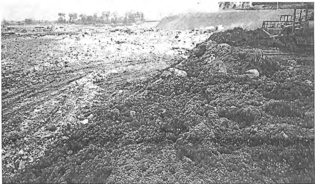
Colocación de capa base en el relleno sanitario Prados de la Montaña
