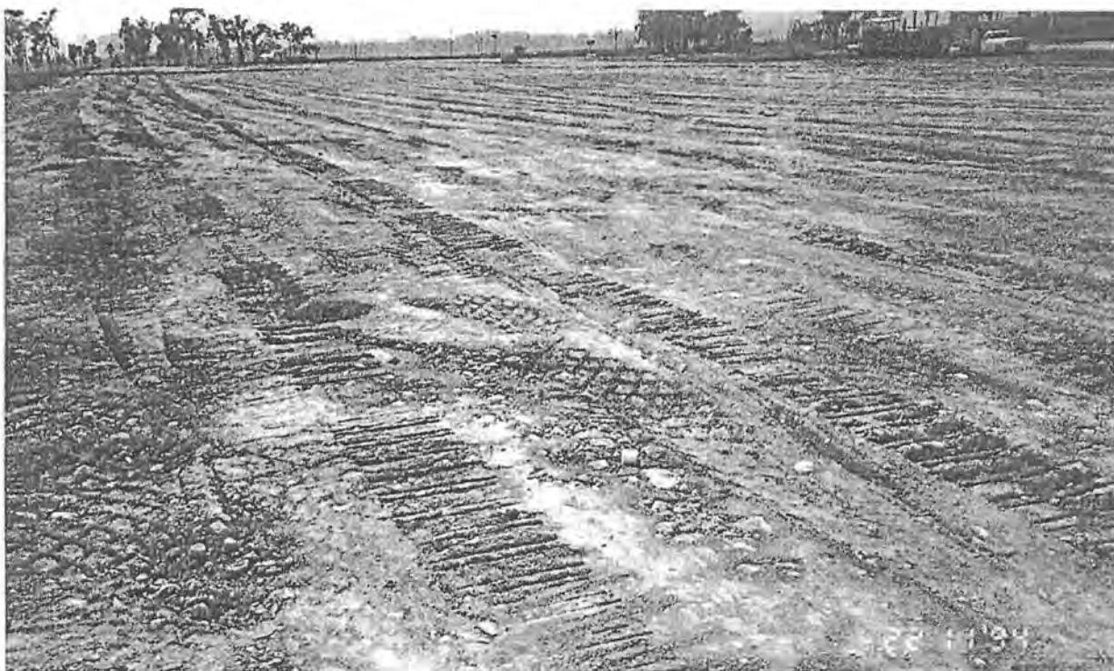
Colocación de capa protectora de erosión en el relleno sanitario Prados de la Montaña
